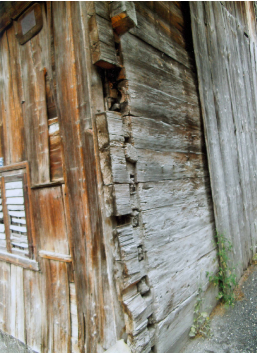
Der stark beschädigte Strick des Jooshuus
