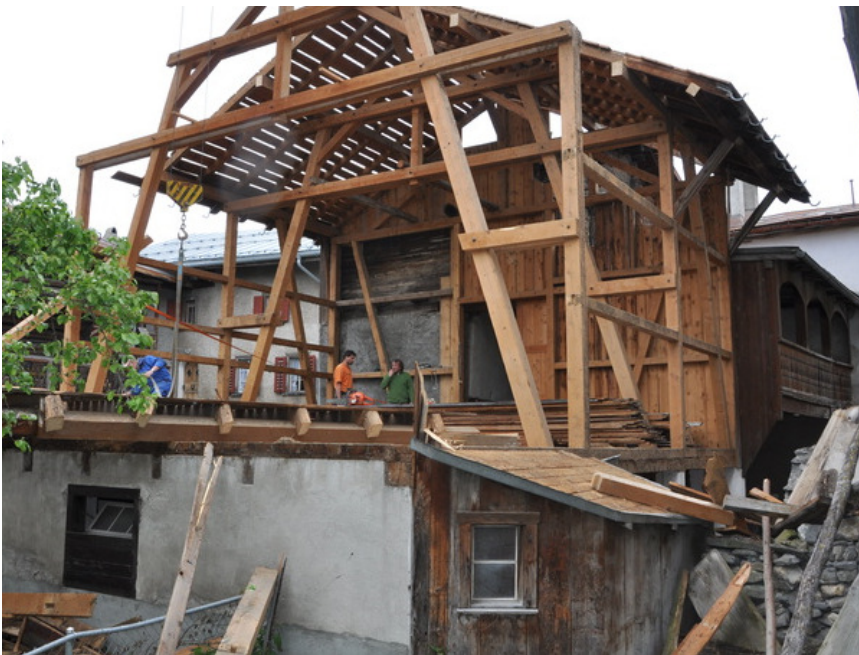
Der Abbruch des Stalles markiert den Baubeginn des Gasthauses am Brunnen im Dorfkern von Valendas.
