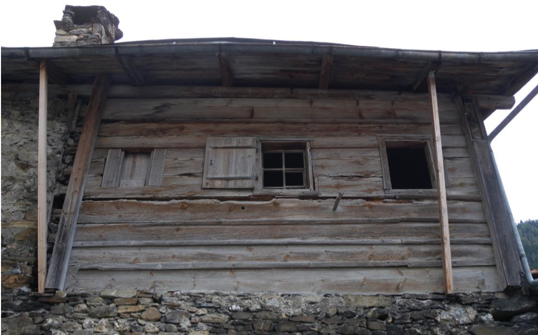
Das provisorisch gestützte Dach des Jooshuus wartet dringend auf eine Sanierung.
