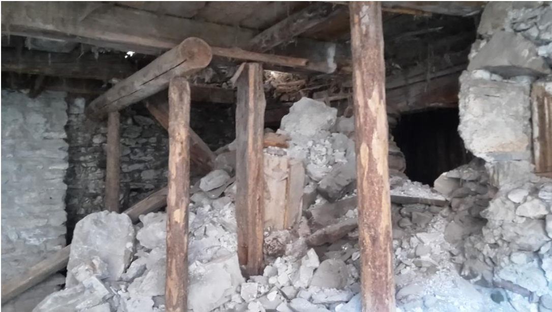
Im Unterstall wird das ganze Ausmass des Schadenfalles sichtbar.
