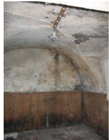
WERTVOLLES RENOVATIONS- BEDÜRFTIGES GEWÖLBE
